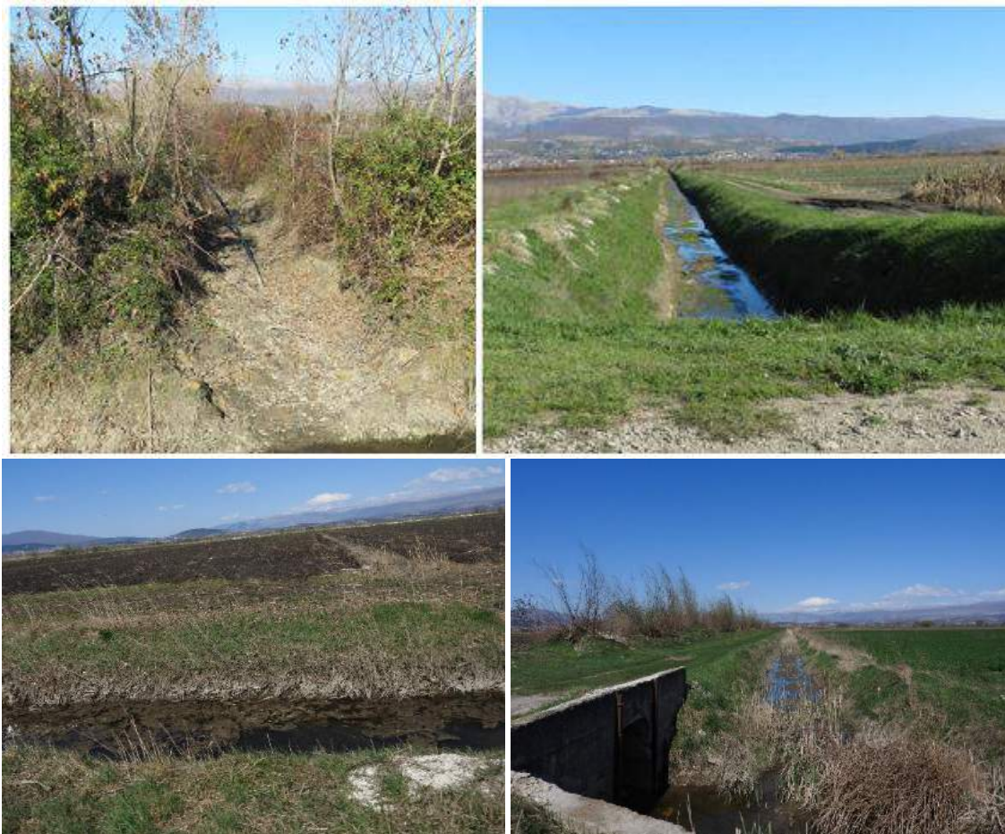
Slika 3. Zapušteni detaljni kanali i sabirni kanali
